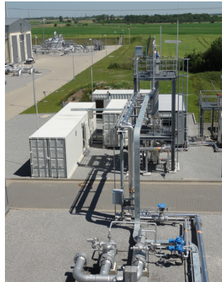
Pilotanlage zur Erdgastrocknung mit Membranen (UGS Staßfurt).
